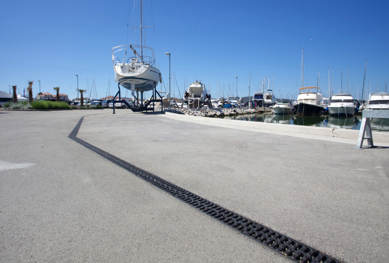
Linijaska odvodnja Multiline kanalima na obalnoj liniji
