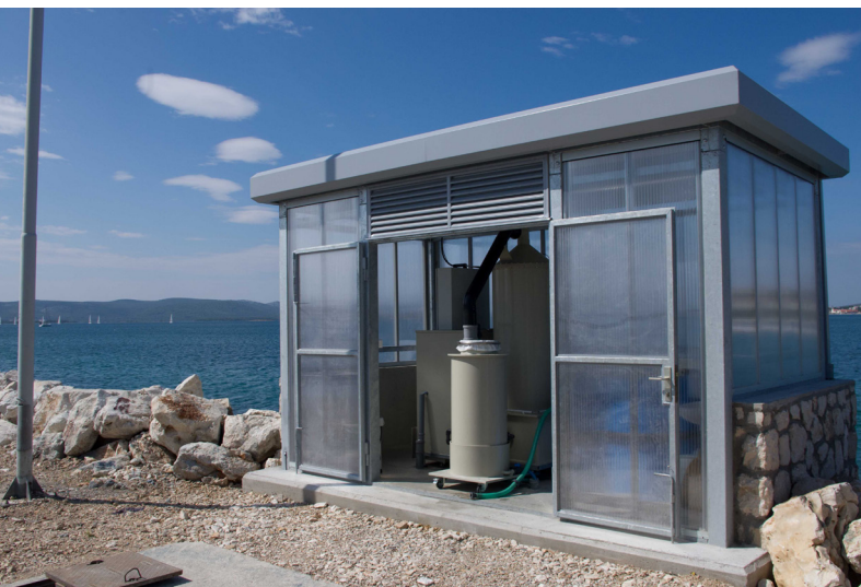
Uređaj AtM-B-600 za tretman otpadnih voda sa prališta brodova
