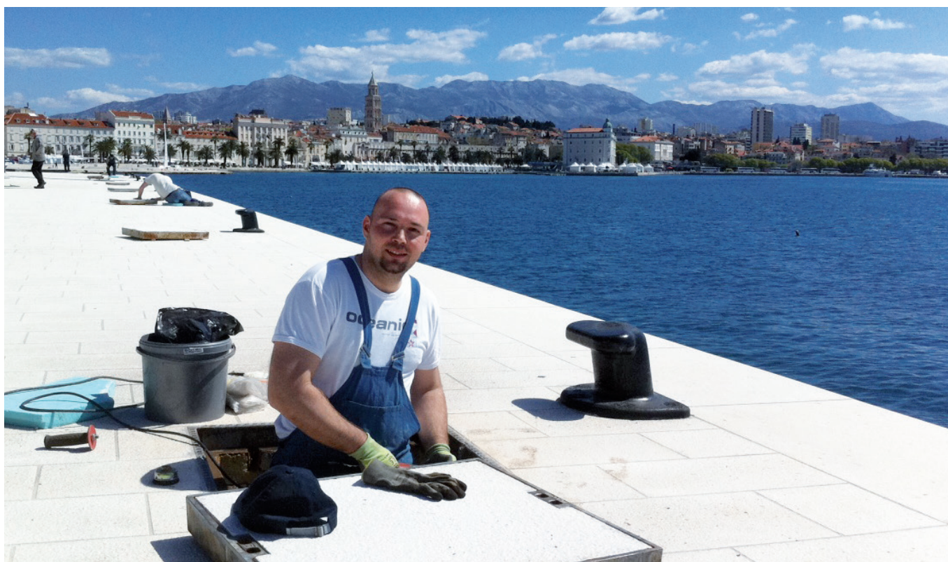
Na zadatku: 2014. godine na Zapadnoj obali u Splitu tijekom revizije ugrađenih poklopaca
